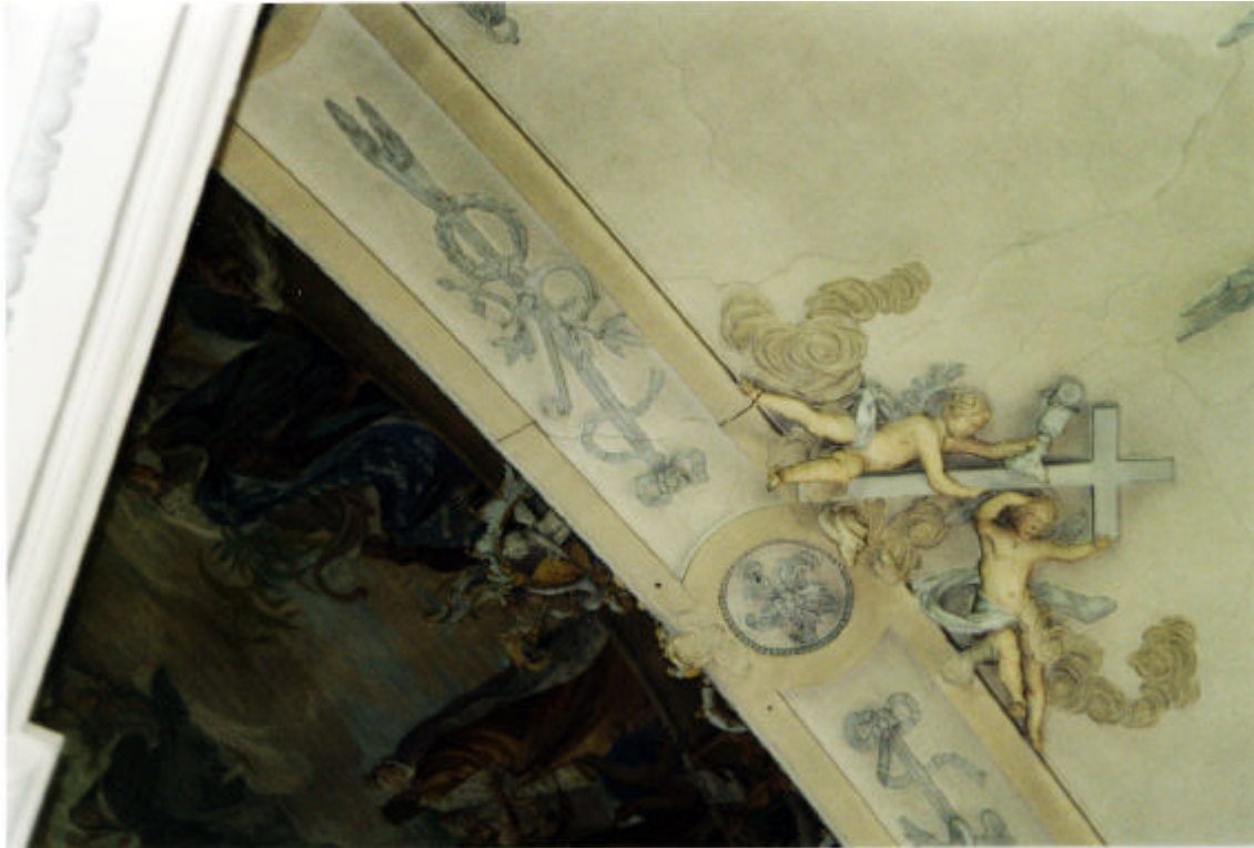
Foto 3: Risse unter Binder 15
