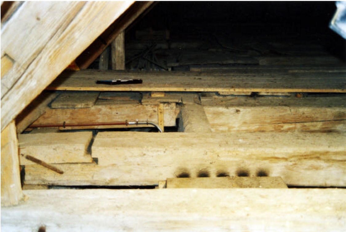
Foto 1: Balkenstösse Binder 8/9 (Nordseite)
